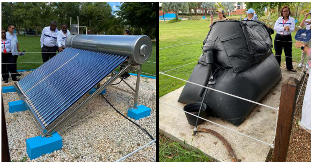
Ilustración 9 Estaciones de calentador solar y estación de biomasa Parque Temático de Energía Renovable Foto: GIZ / Asocapitales, 2026
