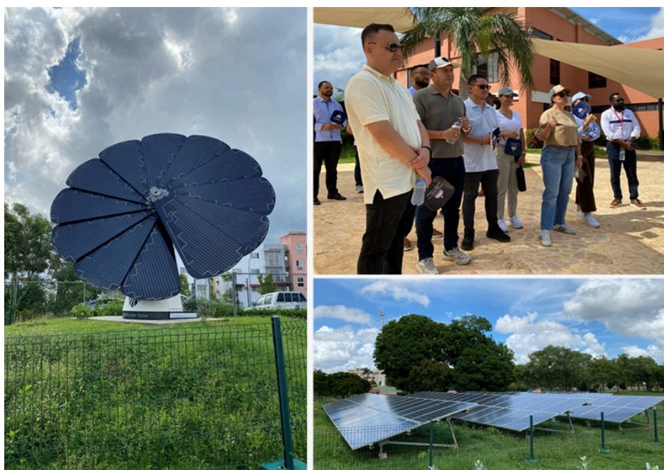
Ilustración 10 Estación Sol Paneles fotovoltaicos instalados en suelo y el sistema Smartflower Foto: Asocapitales, 2026
